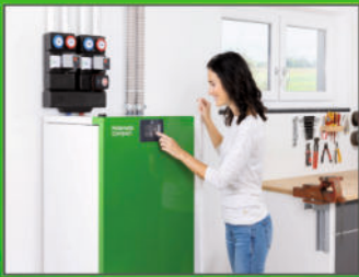
CALDERAS DE BIOMASA
